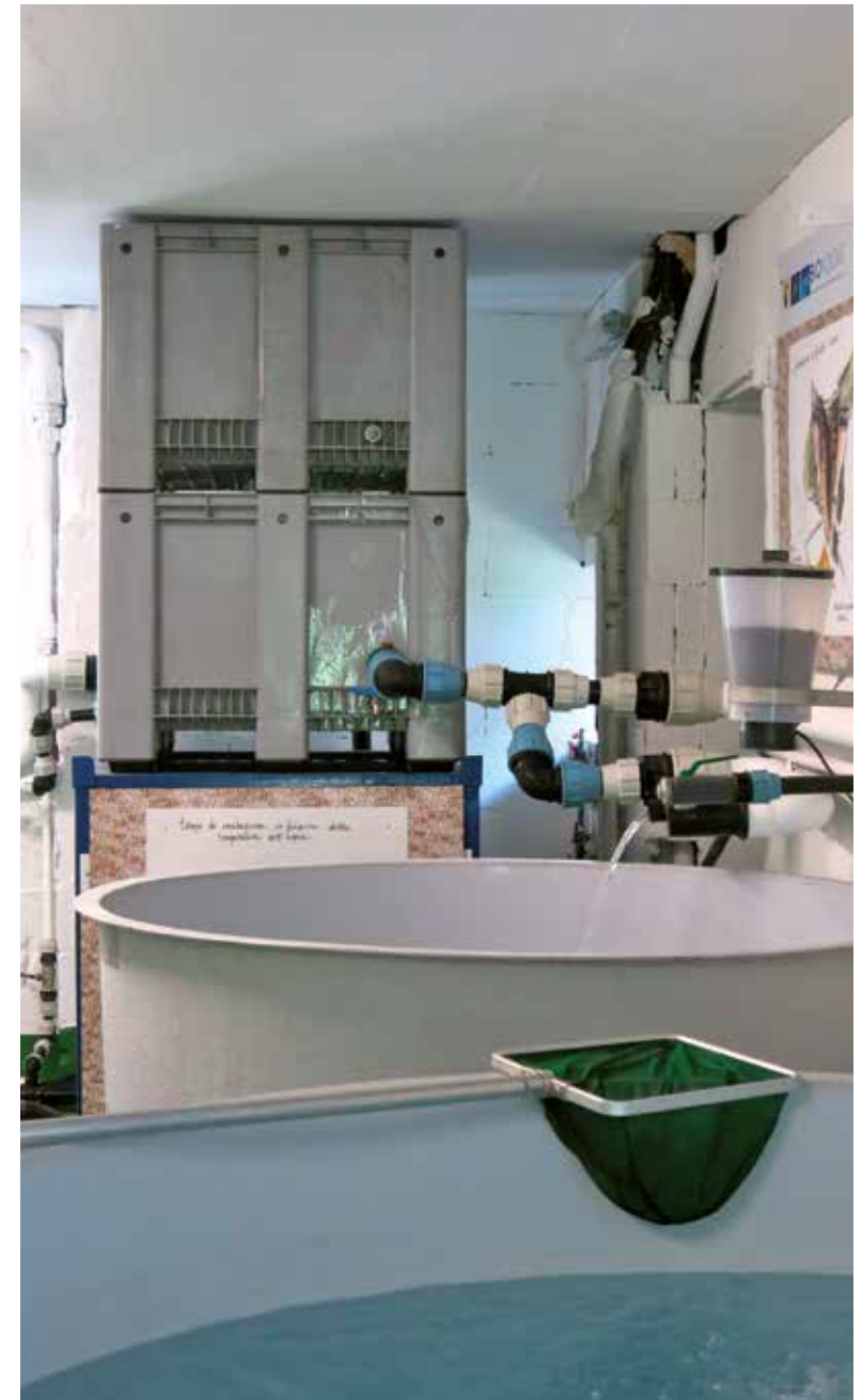
Fig. 11 Impianto per la riduzione della quantità di gas disciolti nell'acqua ("degasatori")
